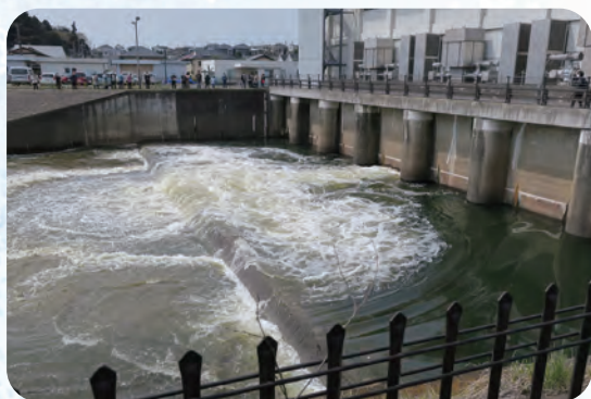
▲大和田排水機場 試運転時写真
